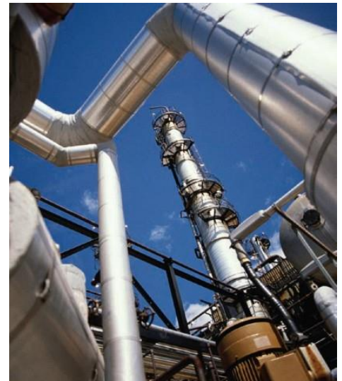
Tuberías en una instalación industrial. (Fuente: DHS)
