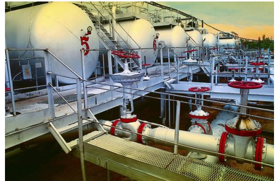
Tanques exteriores en una instalación. (Fuente: DHS)
